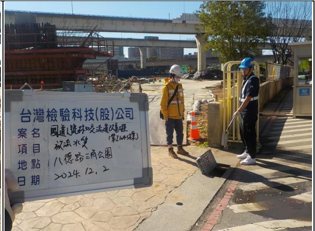
監測項目：放流水質 監測日期：2024.12.02 監測地點：八德路三角公園
